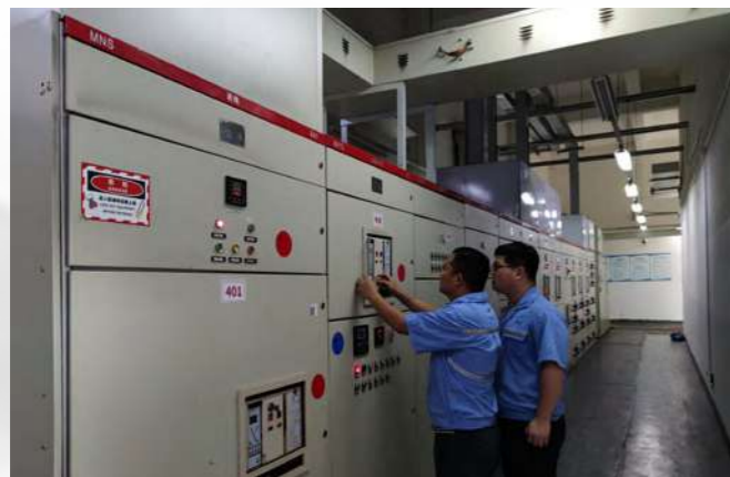
南京 站房负荷控制 NJ Power Station Loading Control
